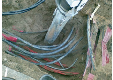
Abb. 9 Saugrohr im Einsatz
