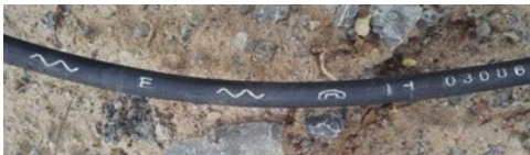
Abb. 2 Glasfaser-Telekommunikations- leitung mit „Wellenlinie“
